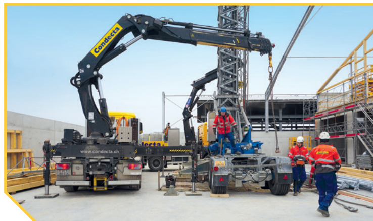
Conducta-Kräne haben sich vielfach im rauen Baustelleneinsatz bewährt und sind in vielen verschiedenen Ausführungen erhältlich, hier bei der Montage
