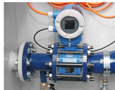
Beispiel integrierte Wassermessung
