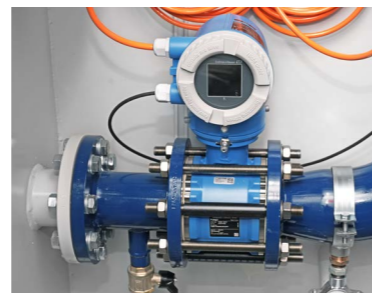
Beispiel integrierte Wassermessung
